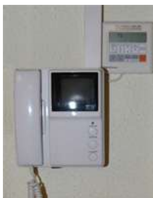
Fig. 2 : Contrôle de l'accès par visiophone
