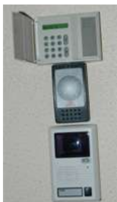
Fig. 1 : Zone pour le contrôle de l'accès à la salle serveur (interphone et lecteur de badge d'accès)
