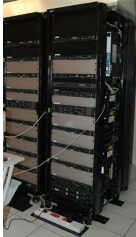
Fig. 5 : Baies avec serveurs en rack
